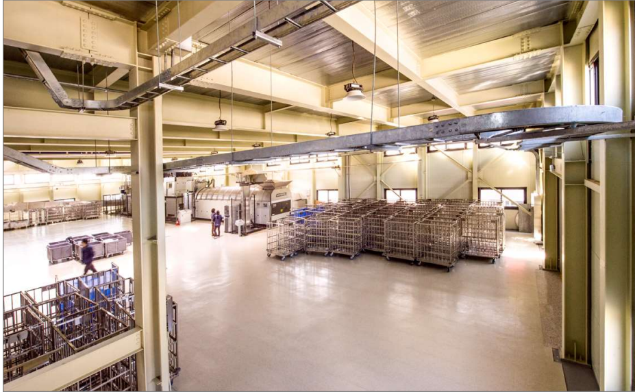
제주런드리 토평세탁공장 A동 전경 [ 입고 → 세탁 → 건조 공정 ] 로딩컨베이어, 터널배치 세탁시스템, 탈수프레스, 건조·탈수기 외
